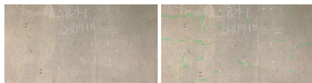
AIによる床版のひび割れ検出例(左:元の床版画像、右:ひび割れ検出後)
